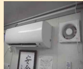
扇風機や換気扇とエアコンを併用
