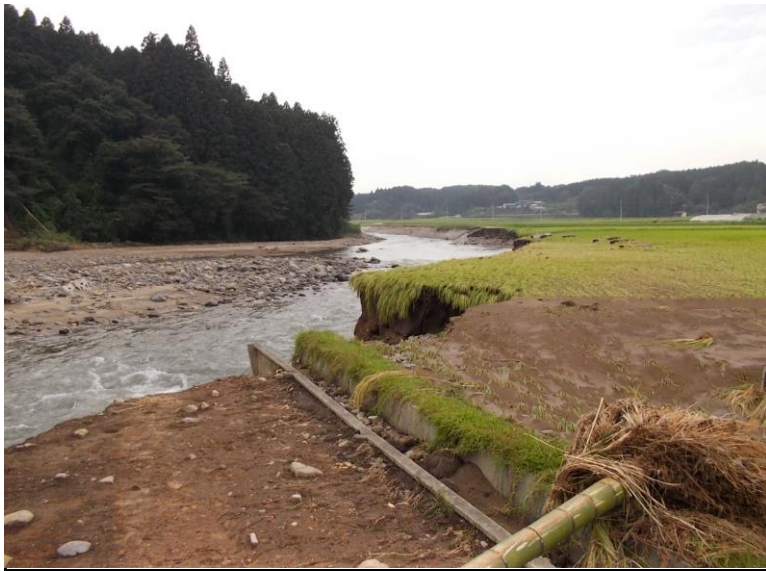
日光市上小倉 9月14日 16:08:21 行川被災状況
