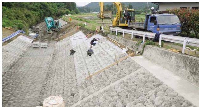
大雨で洗堀された川岸に連結ブロックを布設（日光市 田川）
