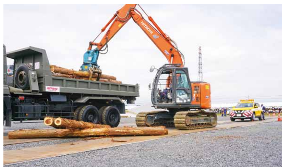
栃木県建設業協会 那須支部等による 『道路啓開訓練』陸上自衛隊の車両に瓦礫を載せる撤去作業
