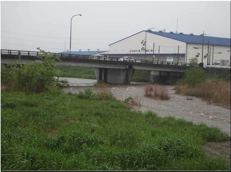
塩谷郡塩谷町田所 5月21日 荒川 荒川橋((主)塩谷喜連川 線)での増水状況
