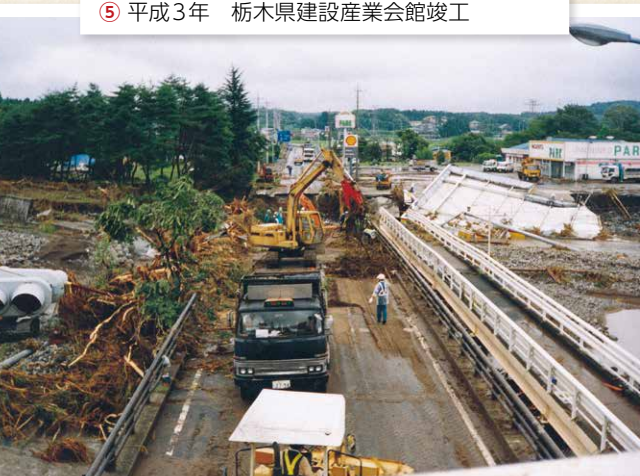
⑥ 平成10年 那須水害による災害復旧
