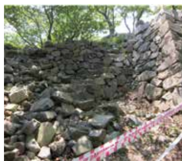
◀天守台に上がる石垣が崩れている
